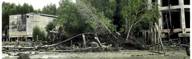
■大水槽结构和地基稳固,惟水压问题而无法蓄水。
